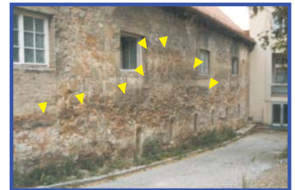
Foto 1: Anomalie der Feuchtesteighöhe über einer Wasserader
